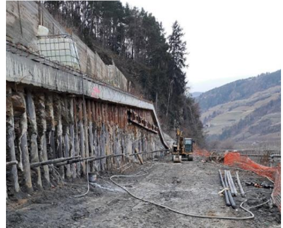
Bild 2 – Schottwand der Zufahrtsstraße am Eingang des Grödnertunnels (NV06) – Dezember 2025
